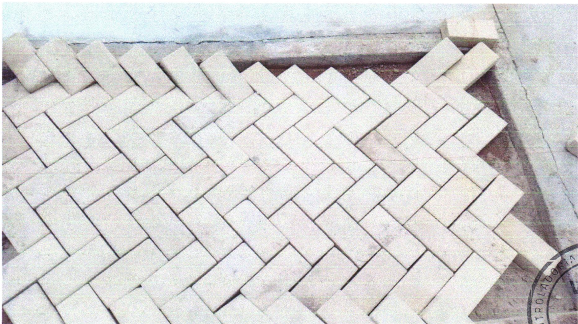
Foto 04 - Pavimentação em bloco de concreto vibroprensado, intertravado, colorido, 10x20cm, e=6cm, 46un/m 2 , NBR9781, Fck(min)=35MPa, sob coxim areia grossa compactada c/ placa vibratória, e(comp.)=6cm, rejuntado c/ areia fina.
